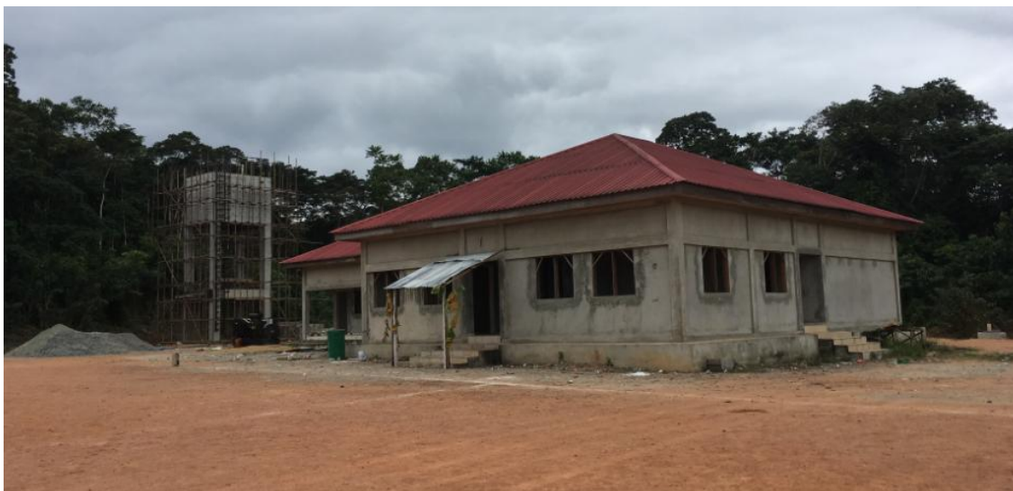
Ilustración 18: Imagen de la nueva escuela en construcción y su torre de agua
